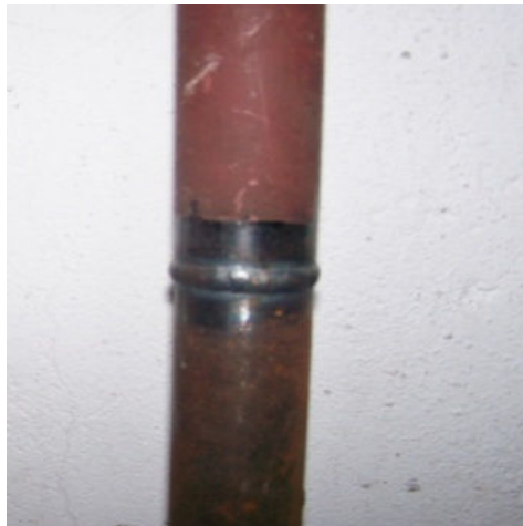
Sl.4 Zavareni spoj čelika 10CrMo9-10 sa čelikom X10CrMoNb9-1.
