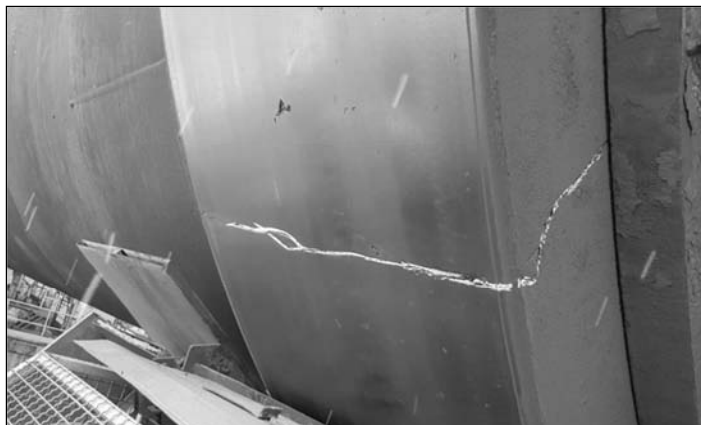
Slika 2. Prslina na nosivom prstenu
